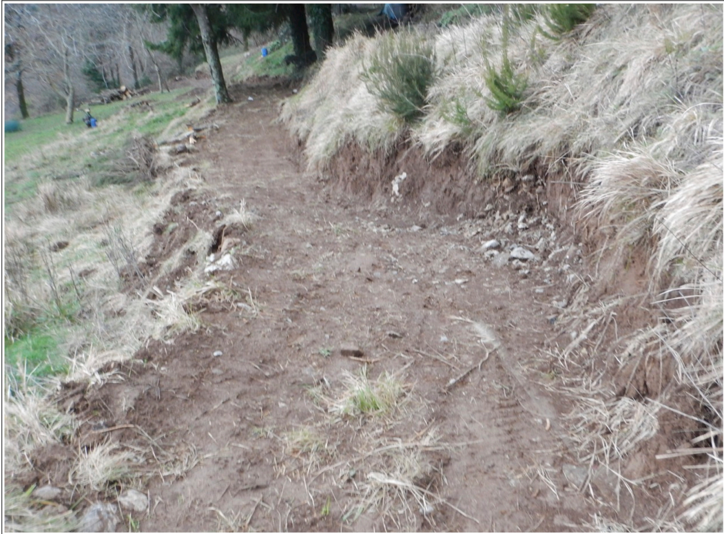
Foto ■ Particolare della parte centrale del tratto di pista; si notino sulla destra, sul lato monte, gli sbancamenti del terreno realizzati con l'escavatore cingolato. Foto del 5 Gennaio 2024.
