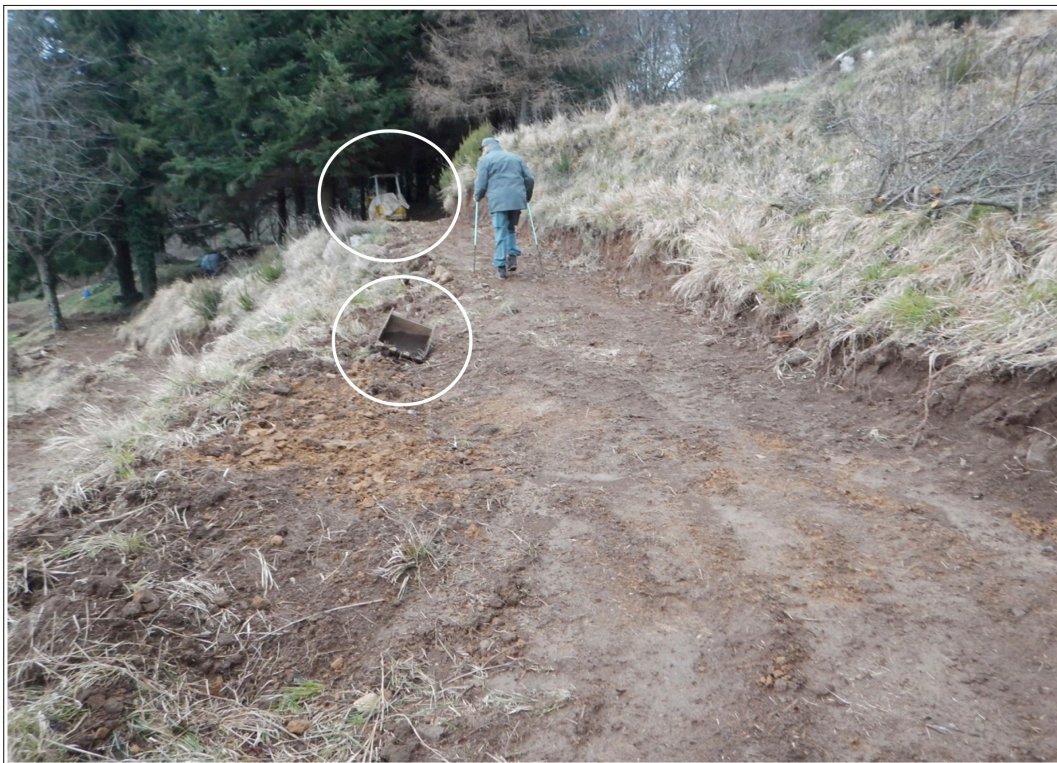
Foto ■ Particolare del tratto del tornante che sale a sinistra; indicata al centro della foto una benna per escavatore e sopra l'escavatore cingolato posto al termine della pista. Foto del 05.01.24.
