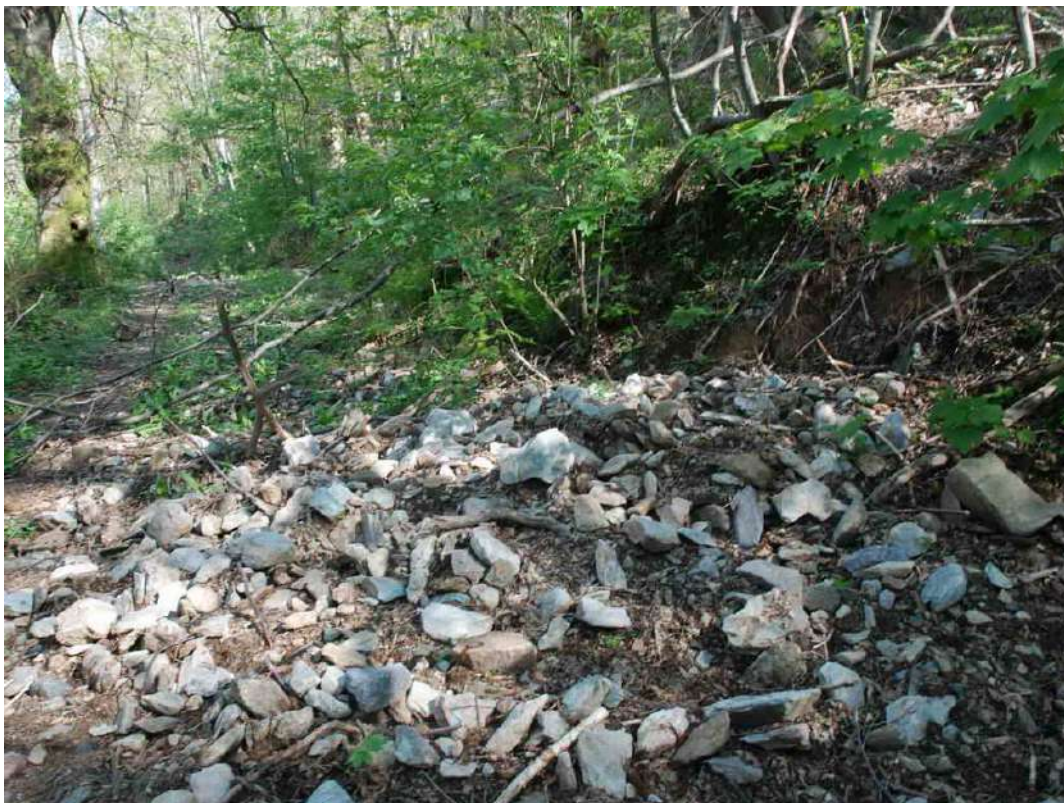
Foto 3 - Lo stato attuale Sentiero 38 con gli attraversamenti completamente intasati dal materiale franato
