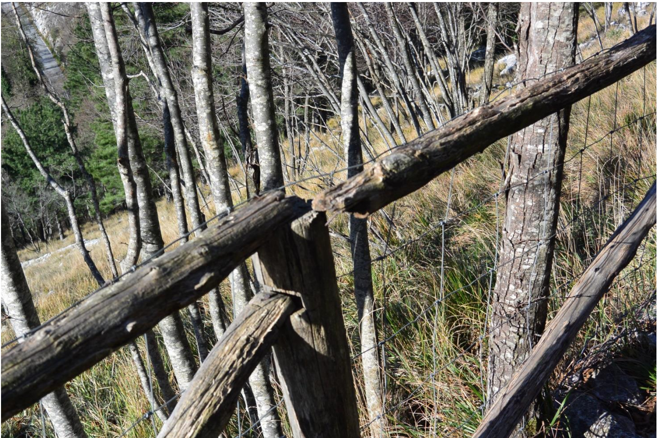
Foto 7 e 8. Tratti di staccionata deteriorata lungo l'itinerario di visita
