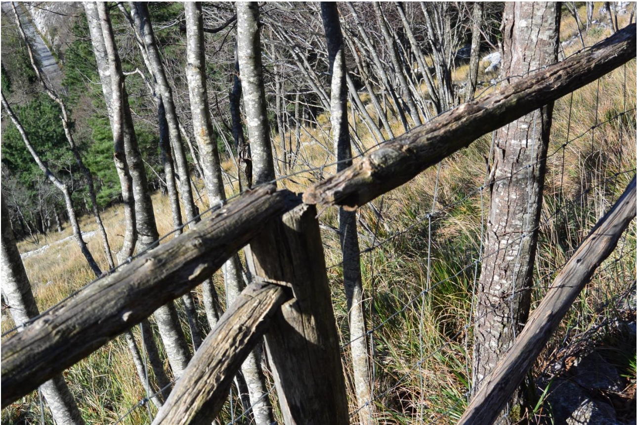
Foto 5 e 6 - Tratti di staccionata deteriorata lungo l'itinerario di visita in salita
