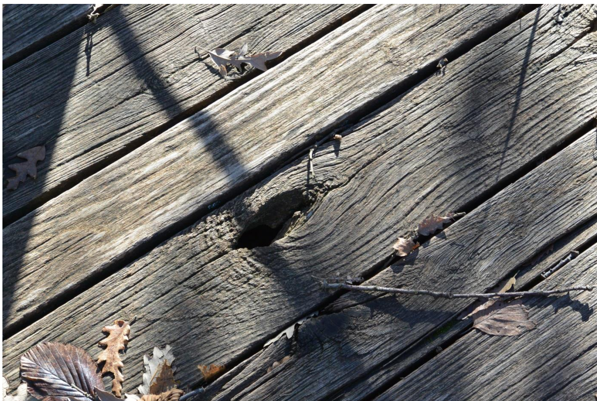
Foto 15. Tavole della passerella in legno deteriorate lungo il percorso ad accesso facilitato
