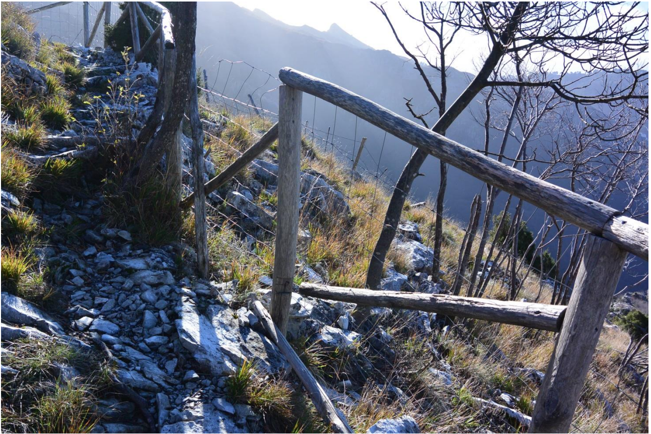
Foto 9. Tratto di staccionata deteriorata lungo l'itinerario di visita e fondo di sentiero dissestato
