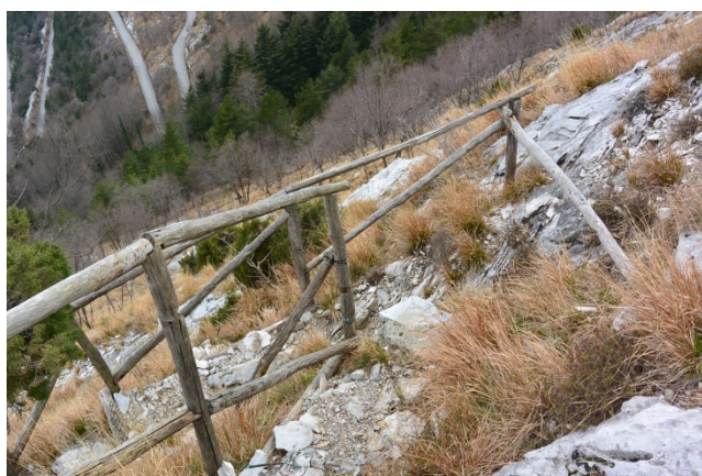
Foto 9. Tratto di staccionata degradato lungo il percorso
