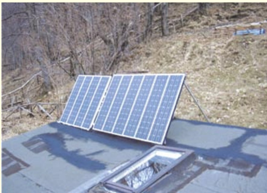
Pannello solare termico installato sulle strutture dell'Associazione Il Sentiero (foto M. Tavoni)
